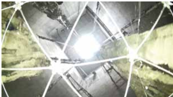
FIGURA 5. Vista desde el fondo del pozo de bombeo (-35 m) hacia la superficie. Se aprecia el problema que significan las toallitas enganchadas en las guías y cableado de las bombas.
