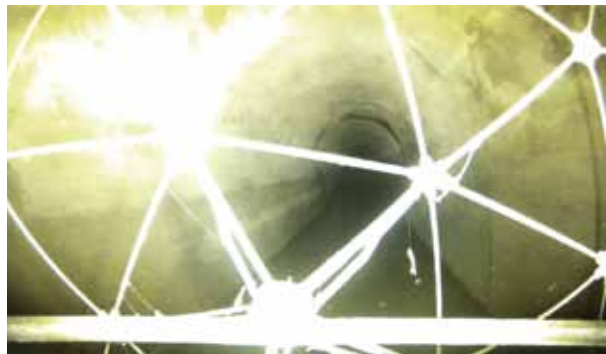
FIGURA 10. Tramo de colector en estado aceptable, programable para renovación a medio plazo.
