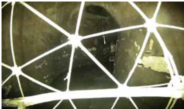
FIGURA 9. Paredes del colector en mal estado, flujo y lodos densos en el fondo.
