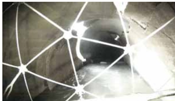
FIGURA 4. Mediante los vídeos grabados con el dron se pudo evaluar el grado de daños: solera desprendida, en un caso, y colector fisurado en una longitud importante en el otro.
