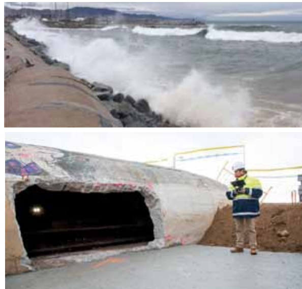
FIGURA 3. Temporal y colector roto (imagen cedida por Aigües de Barcelona) y inspección urgente con dron.
