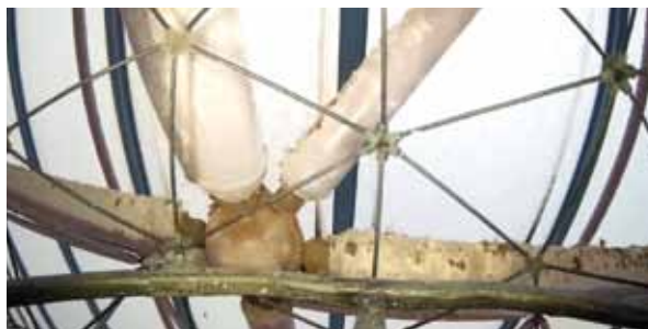
FIGURA 8. Inspección de la estructura metálica en altura (30 m). Se observa el deterioro de la pintura y la oxidación leve de las barras metálicas.
