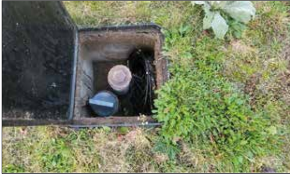
Data logger y sensor LTC de Sofrel para la medida de calidad en aguas subterráneas.
